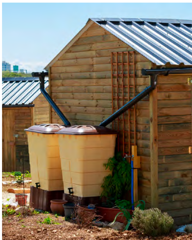
Система збору дощової води з даху будівлі (фото з мережі)
